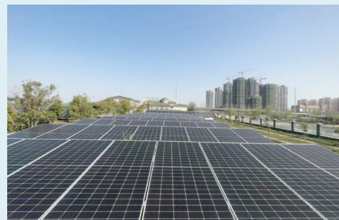
黄冈分布式光伏项目现场
