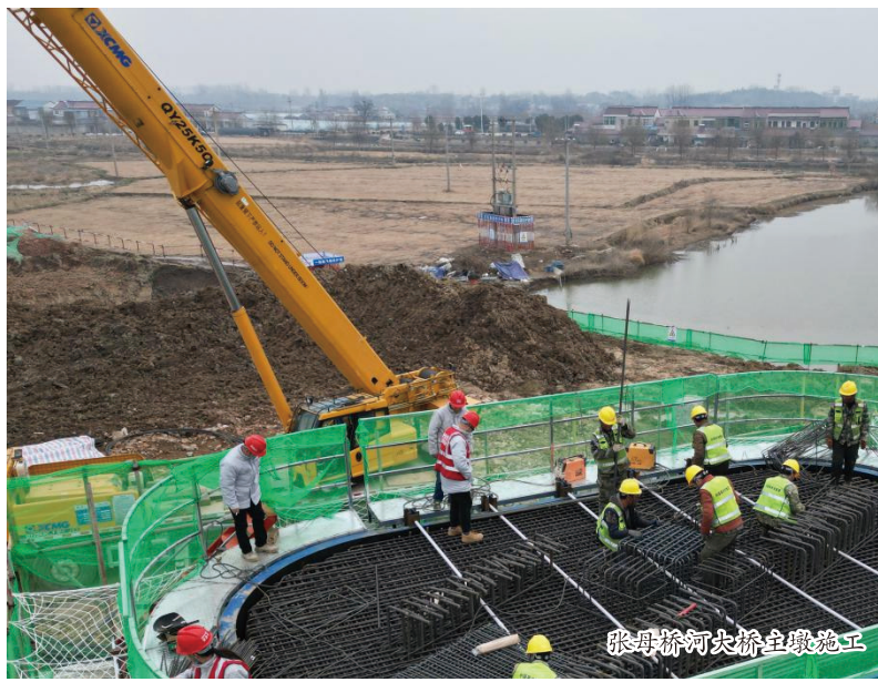
操作不规范现象，易导致安全事故发生。
